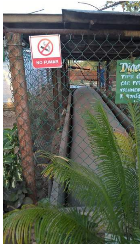
L'actuel bio digesteur alimentant en biogaz les cuisines
